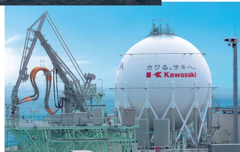
液化水素 貯蔵タンク
